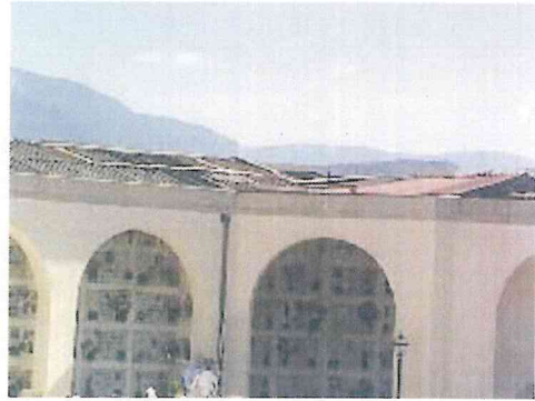
Il tetto di eternit del cimitero di Mori, scoperto dal vento in agosto
