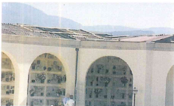
Il tetto del cimitero di Mori danneggiato dal vento
