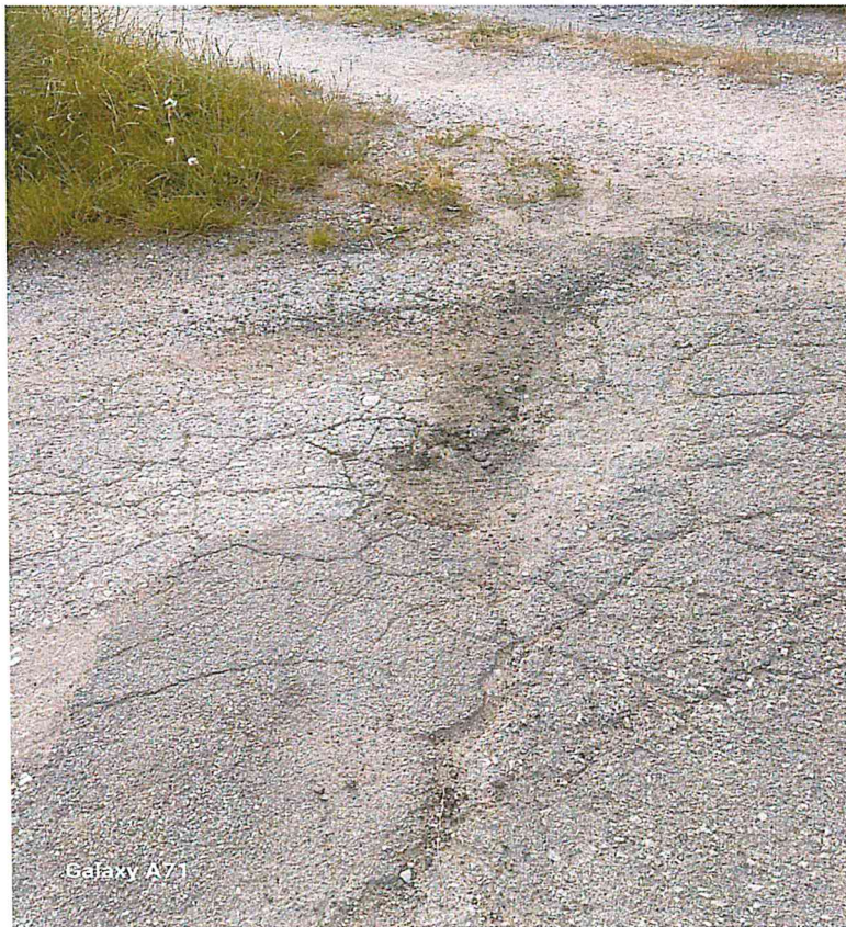
MANTO STRADALE SCONNESSO
